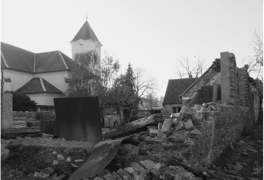
Obr. 9. Průběh demolicе hospodářských budov domu čp. 51 ve Strachotíně. Vpravo vzadu ještě stojící původní zed'. Foto Jana Křivánková, 2020/2021.
